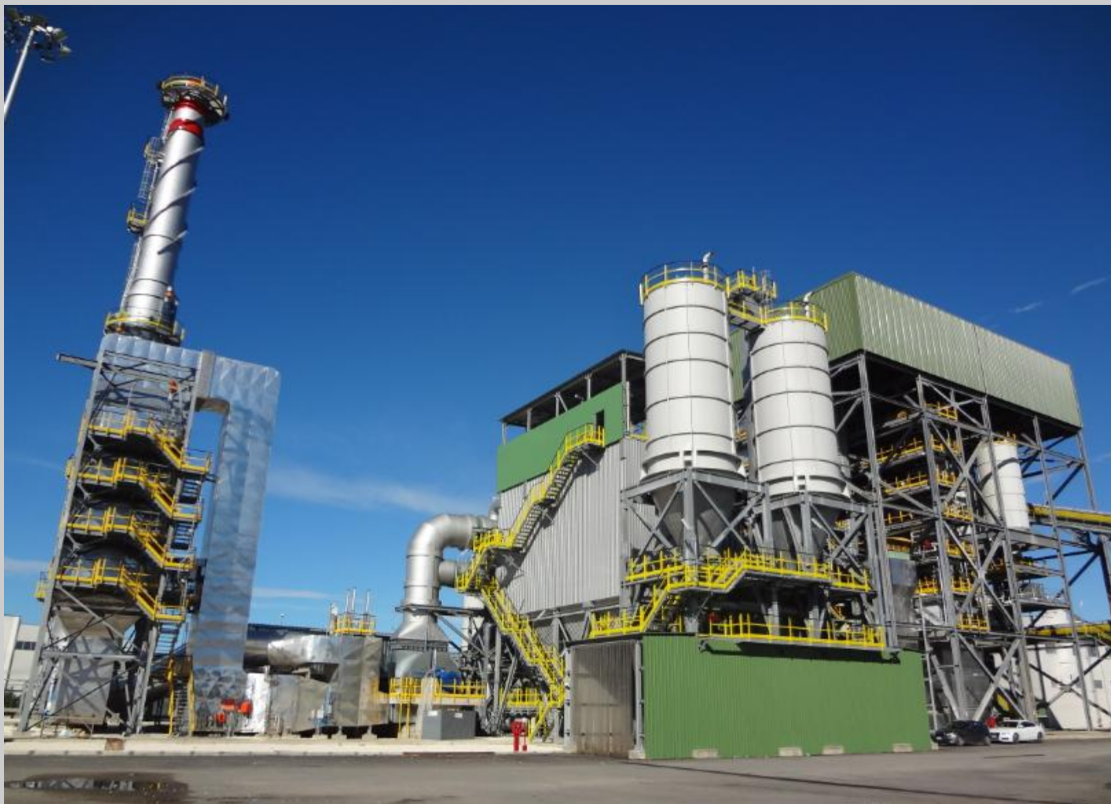
STATION D'ÉPURATION DE L'AIR – INCINÉRATION DES DÉCHETS (DSM)
